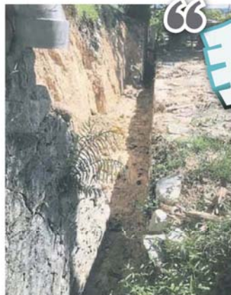
草坡崩塌后，大量黄泥冲入沟渠，影响排水。
