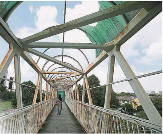
行人天桥的桥顶盖原本已开始出现破损,在数日前的一场大风雨后,更是全都被吹破了。
