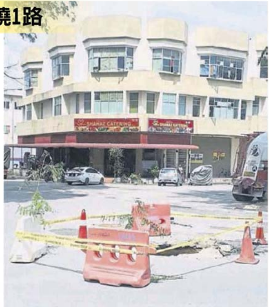
■坑洞位于大路，为防意外发生，当局以警戒线围起及设立塑料路障。
