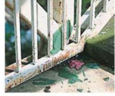
行人天桥上及栏杆都可发现许多锈顶盖的碎片。
