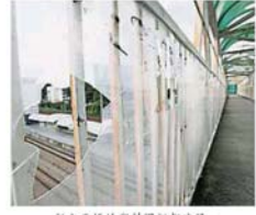
行人天桥的塑料固框都破了。
