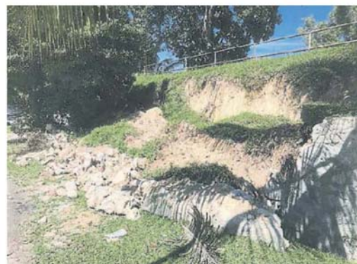
第2次崩塌的草坡。
