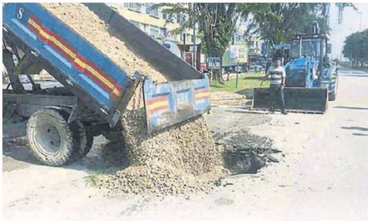
■市议会用沙石暂时填补大洞，防止坑洞继续崩陷。
